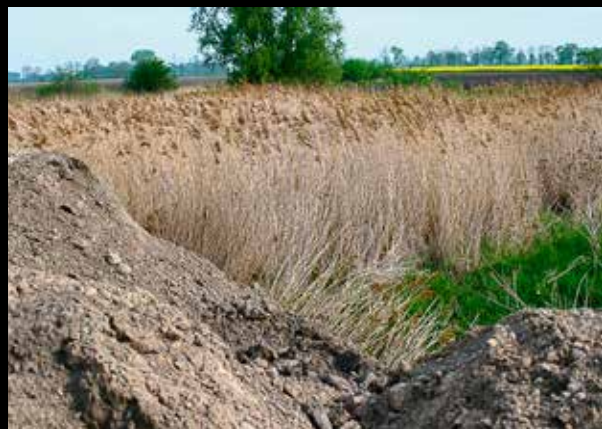
FOT.9. PRZEBUDOWA DROGI KRAJOWEJ 62. EFEKT- ZASYPIANIE WIELU OBSZARÓW WODNO - BŁOTNYCH NA TERENIE OSTOI NADGOPIAŃSKIEJ PLB 040004
